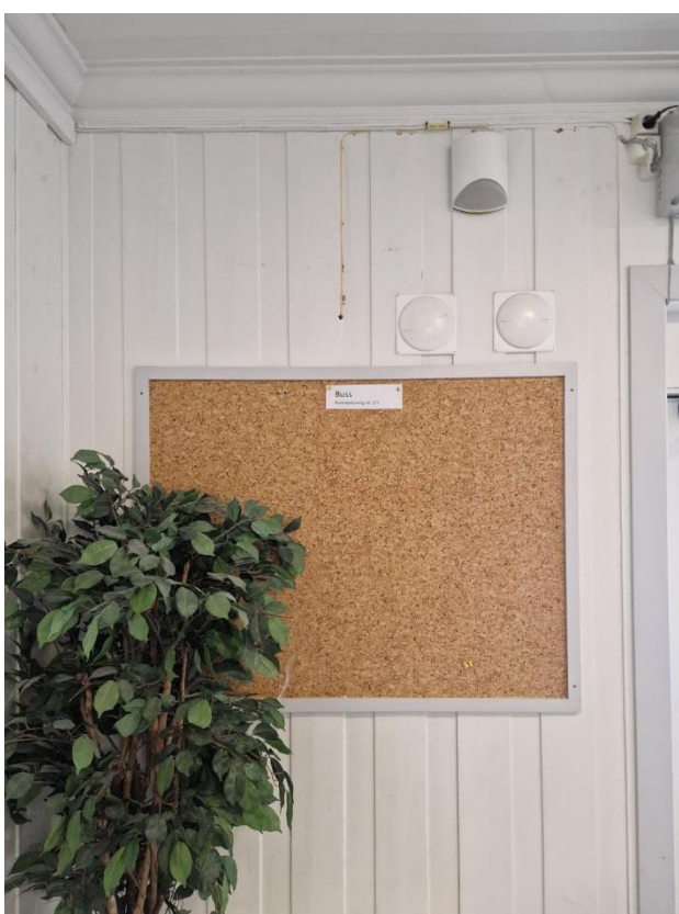
Figur 16 Mangel på ruteinformasjon inne i venterom
